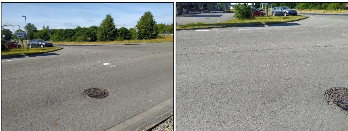
Abbildung 9: Einmündung Paxtonstr. / Mendelstr. – Abgenutzte Markierungen Linksabbiegespur (Quelle: Aufnahme IPW)
