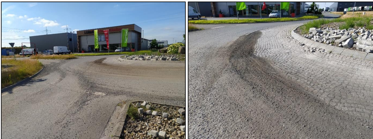
Abbildung 6: Kreisverkehr Paxtonstr. / Merianstr. – Beschädigungen Innenring (Quelle: Aufnahme IPW)
