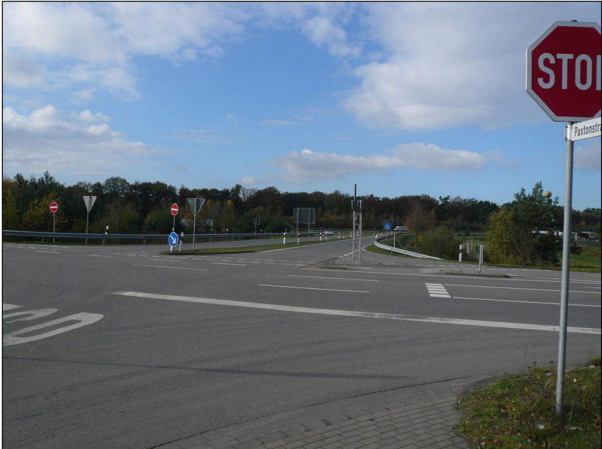
Abbildung 5: Fehlende Querungshilfe L 40 - Blickrichtung: A 31 AS Emsbüren (Quelle: Eigene Aufnahme)
